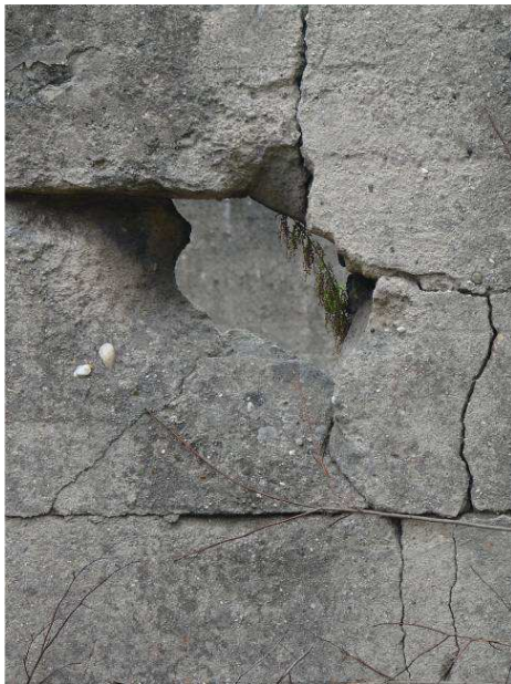
Szczegół uszkodzenia w ścianie wschodniej.
