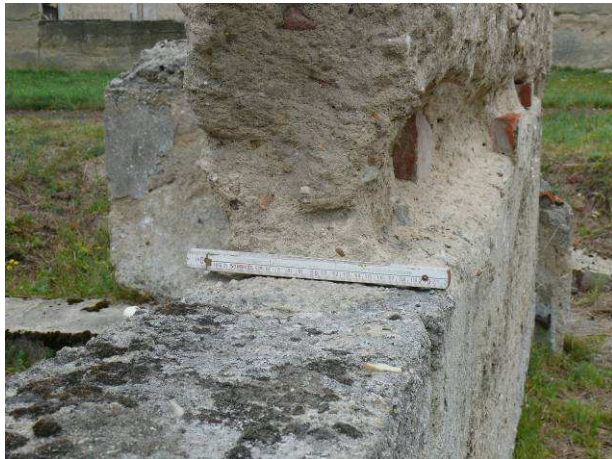
Widok na zniszczenia erozyjne ściany.
