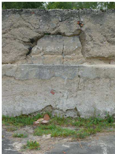
Ubytek betonu w ścianie zachodniej.
