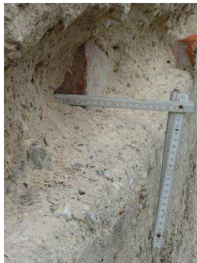
Ubytek betonu w ścianie.
