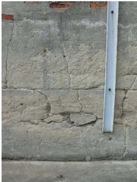
Ściana wewnętrzna strona zachodnia – szczegół zniszczeń ściany
