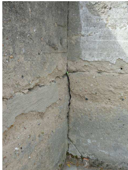
Ściany wewnętrzne strona południowo- zachodnia – szczegół zniszczeń ściany.
