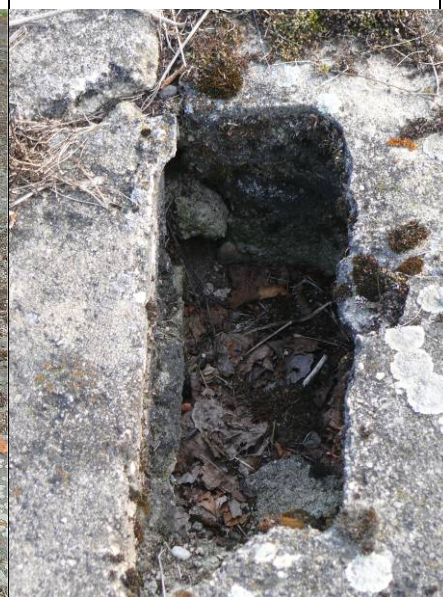
Otwór w posadzce po słupie i zastrzale
